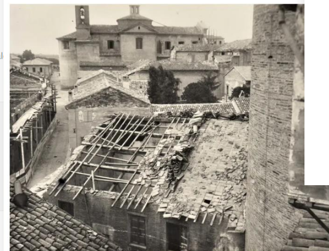
Figura 3 - Dannì nel centro storico di Senigallia (da Santoni, 2017)
