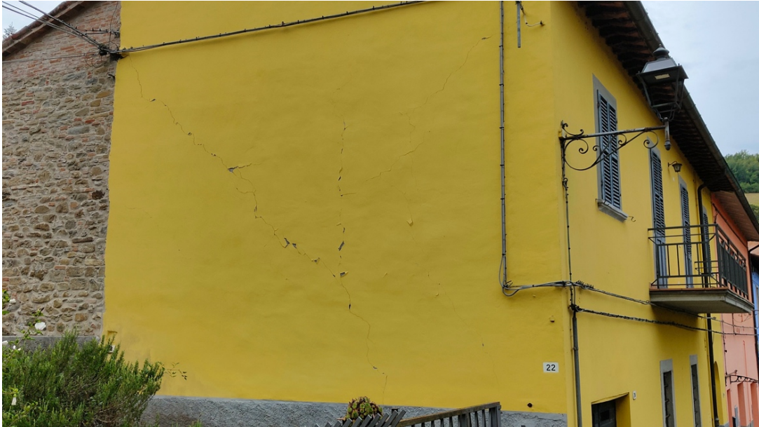
Fig. 8. Lesioni su muratura in un edificio a Trezio (FC)
