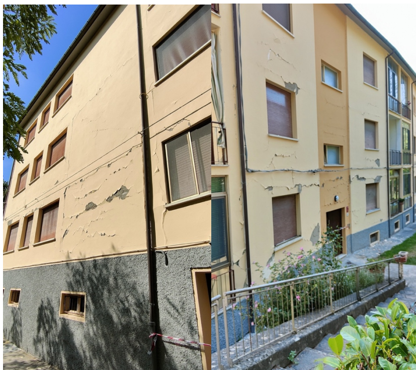
Fig. 11. - Lesioni alle tamponature in edifici in c.a. in via Cappelli Licinio, Rocca San Casciano (FC)
