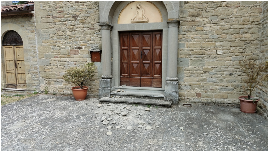
Fig. 9. Distacchi e cadute di pietre e frammenti dalla facciata della Chiesa di Santa Maria (Popolano, Marradi)
