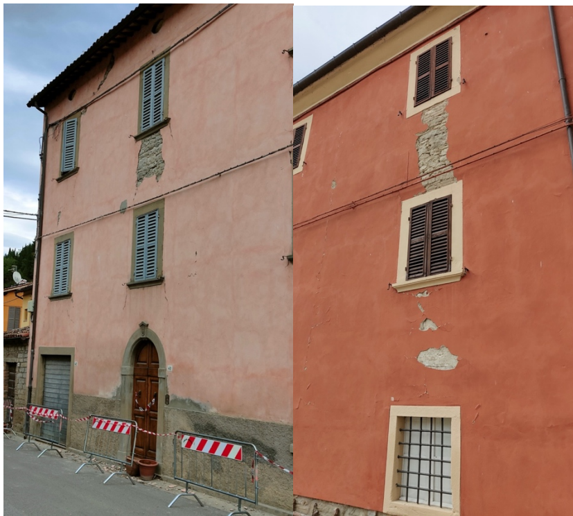
Fig. 10. Lesioni e distacchi di intonaci su muratura in vecchie case a Trezzio (FC)
