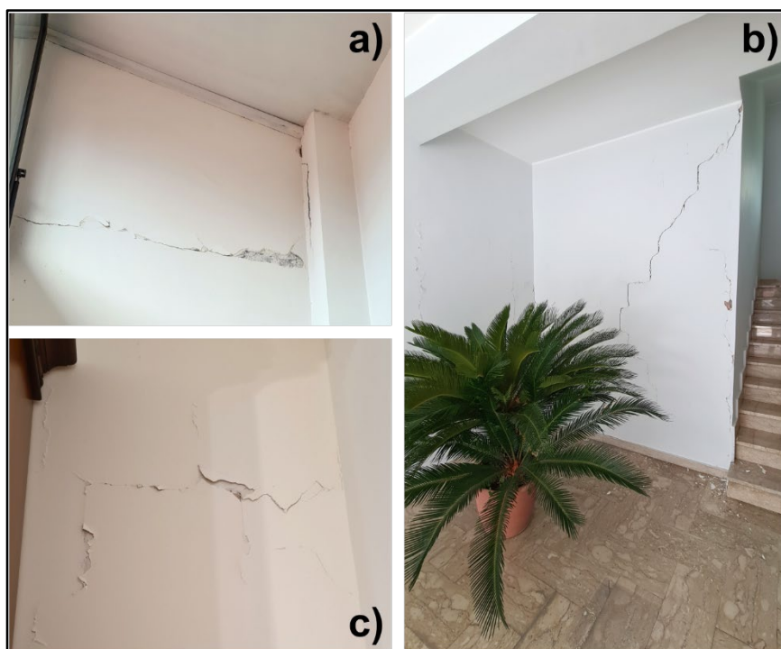
Figura 1. Caduta di intonaci e lesioni ai tramezzi in località Guardia: a) edificio con classe di vulnerabilità C; b-c) edifici con classe di vulnerabilità D.
