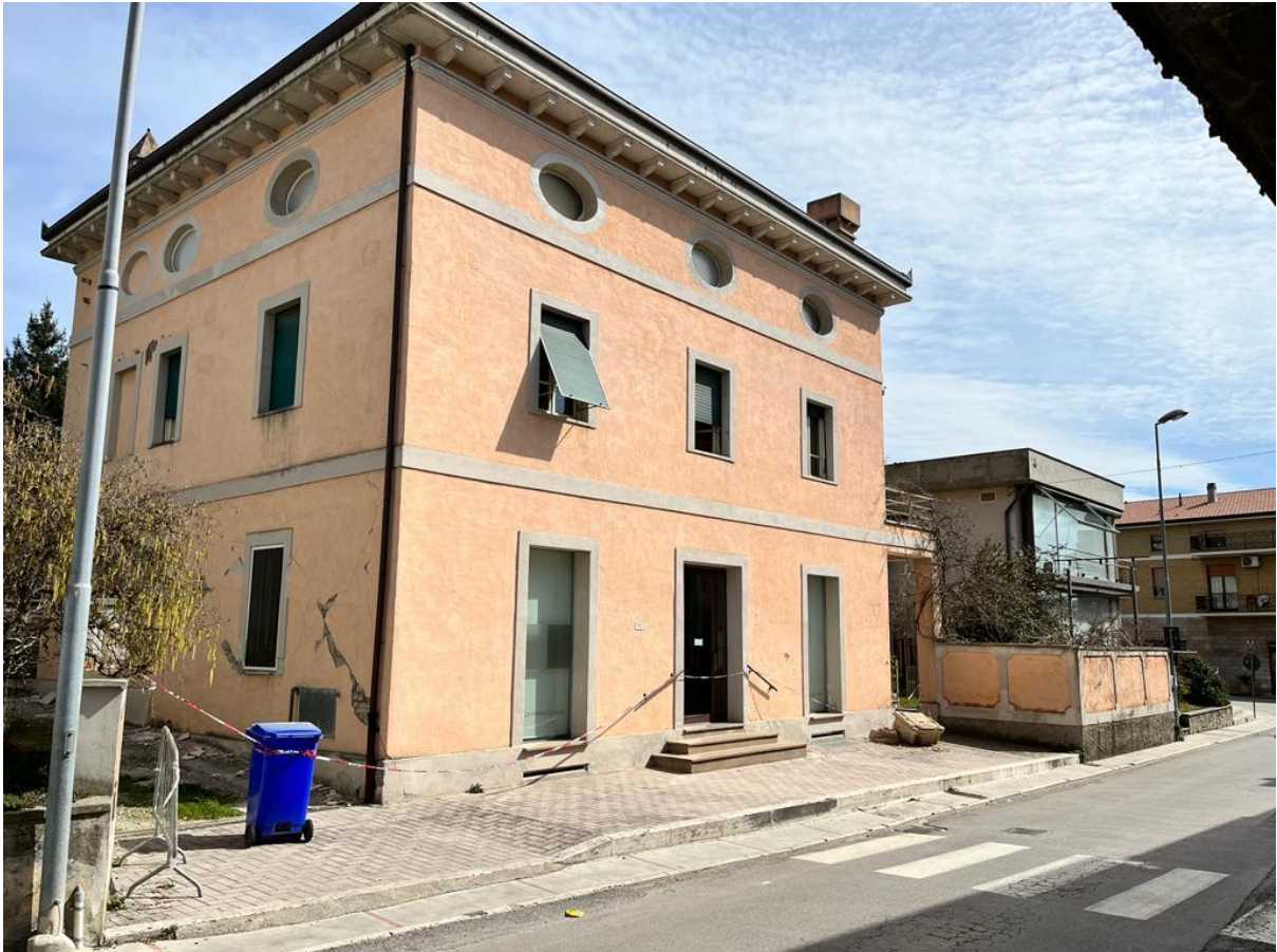
Fig. 6. Crepe diagonali e caduta del camino in un edificio in muratura a Pierantonio.
