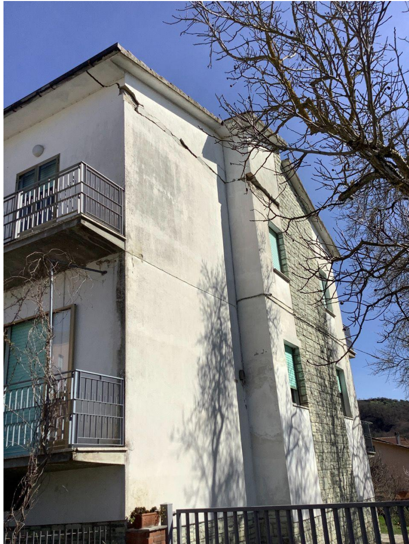
Fig. 7. Lesione orizzontale in un edificio in muratura a Pierantonio.
