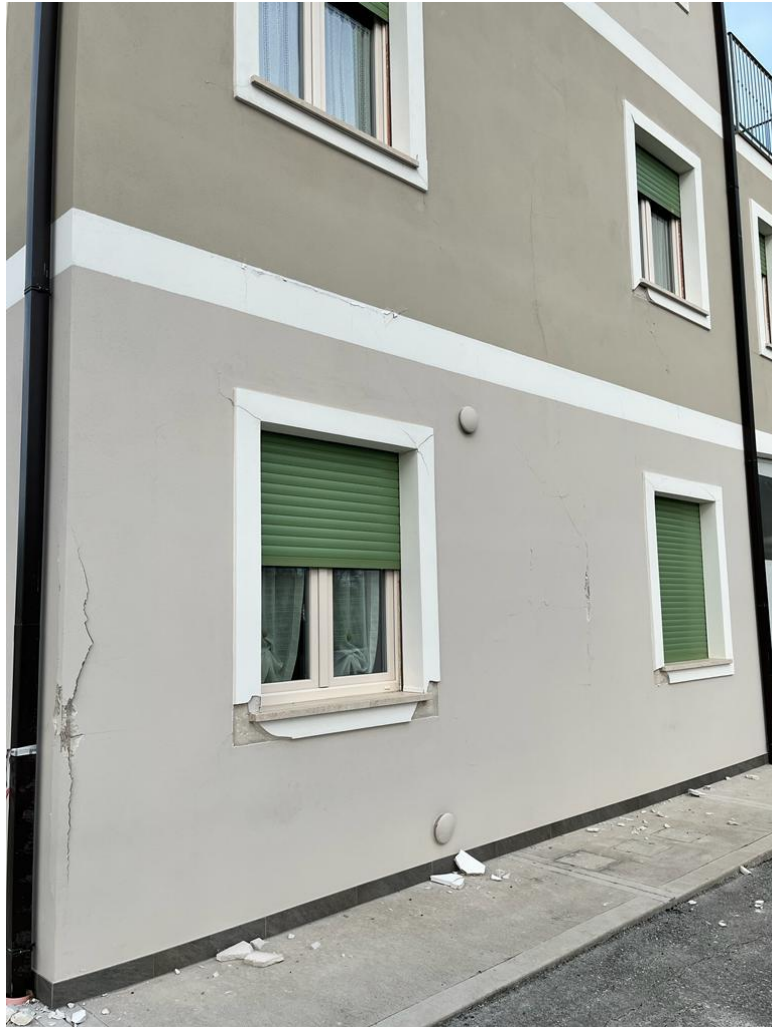
Fig. 9. Crepe verticali, distacco di intonaco e caduta di rivestimenti (grado 2) in un edificio in cemento armato a Pian d'Assino.
