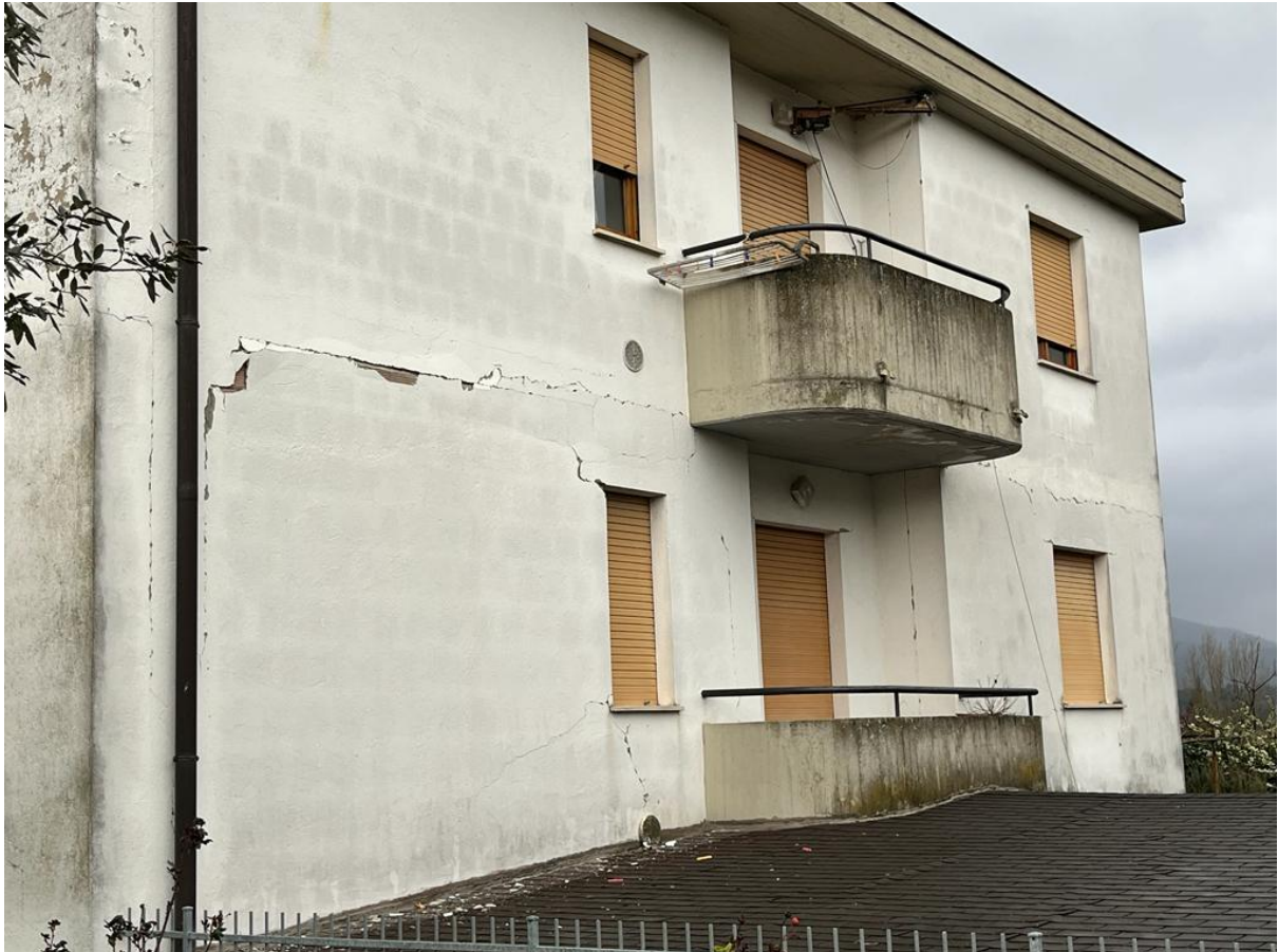
Fig. 10. Lesioni alle tamponature di un edificio in cemento armato a Tavernacce.
