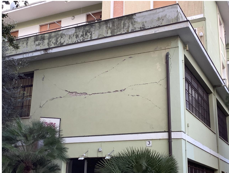
Fig. 8.- Lesioni alla tamponatura in edificio in c.a. in viale dell'Industria, Ancona.
