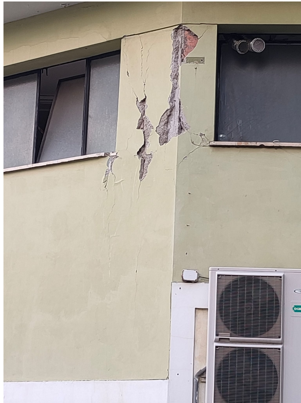
Fig. 9. Distacco di intonaco su colonna in c.a. localizzato nel tratto delle aperture, in via Barilatti, Ancona.
