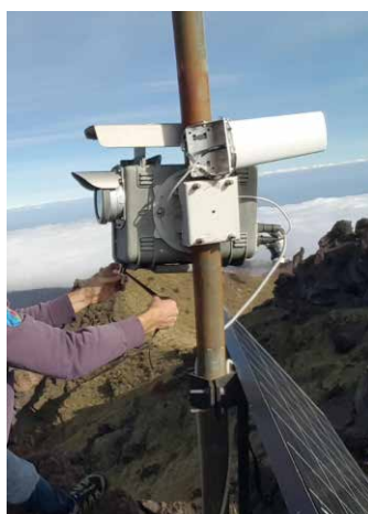
Figura 23 Installazione termocamera di sorveglianza vulcanica in zona Schiena dell'asino (Etna) con trasmissione cellulare UMTS. Nella foto è possibile distinguere la telecamera e l'antenna direttiva a larga banda (1700-2500 MHz).
