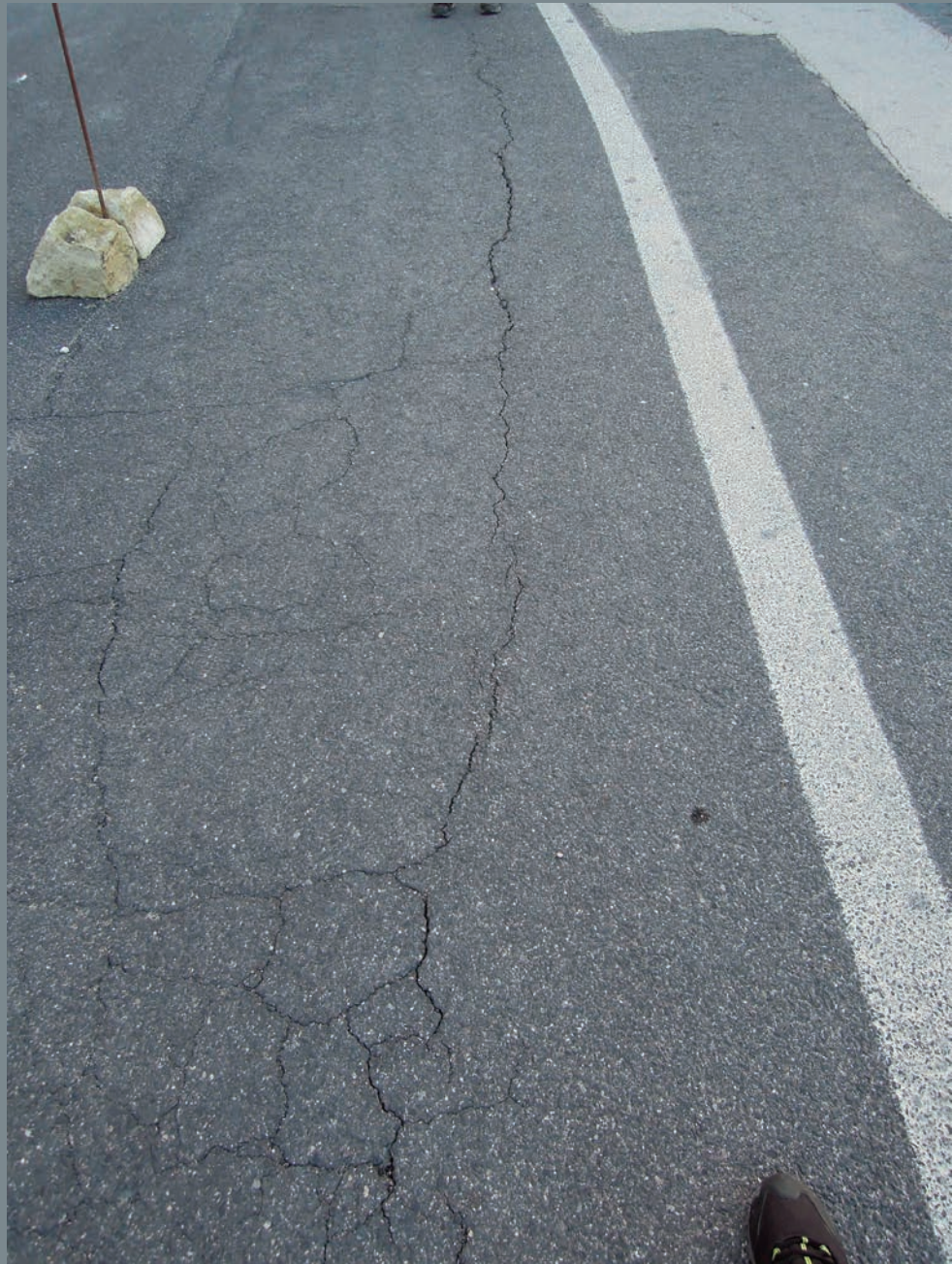
Photo 45 (40.742054° 13.899618°) The fracture in tarred Via Montecito.
