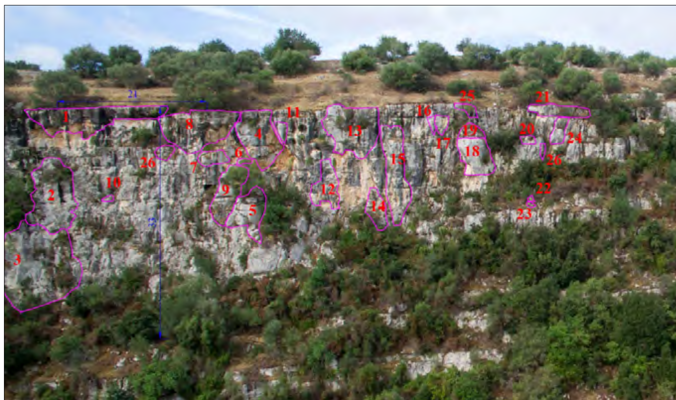
Figura 8. Panoramica dei blocchi instabili a ridosso dell'insediamento in progetto.
