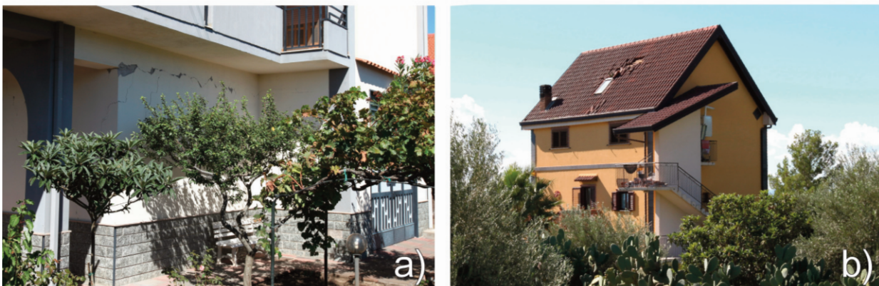
Foto 5 Località Anime del Purgatorio, lungo la S.P. 229/II (S. Maria di Licodia): a) distacco tra telaio e tramezzature di un edificio in c.a. (cl. D); b) scivolamento di tegole in un edificio di recente costruzione.
