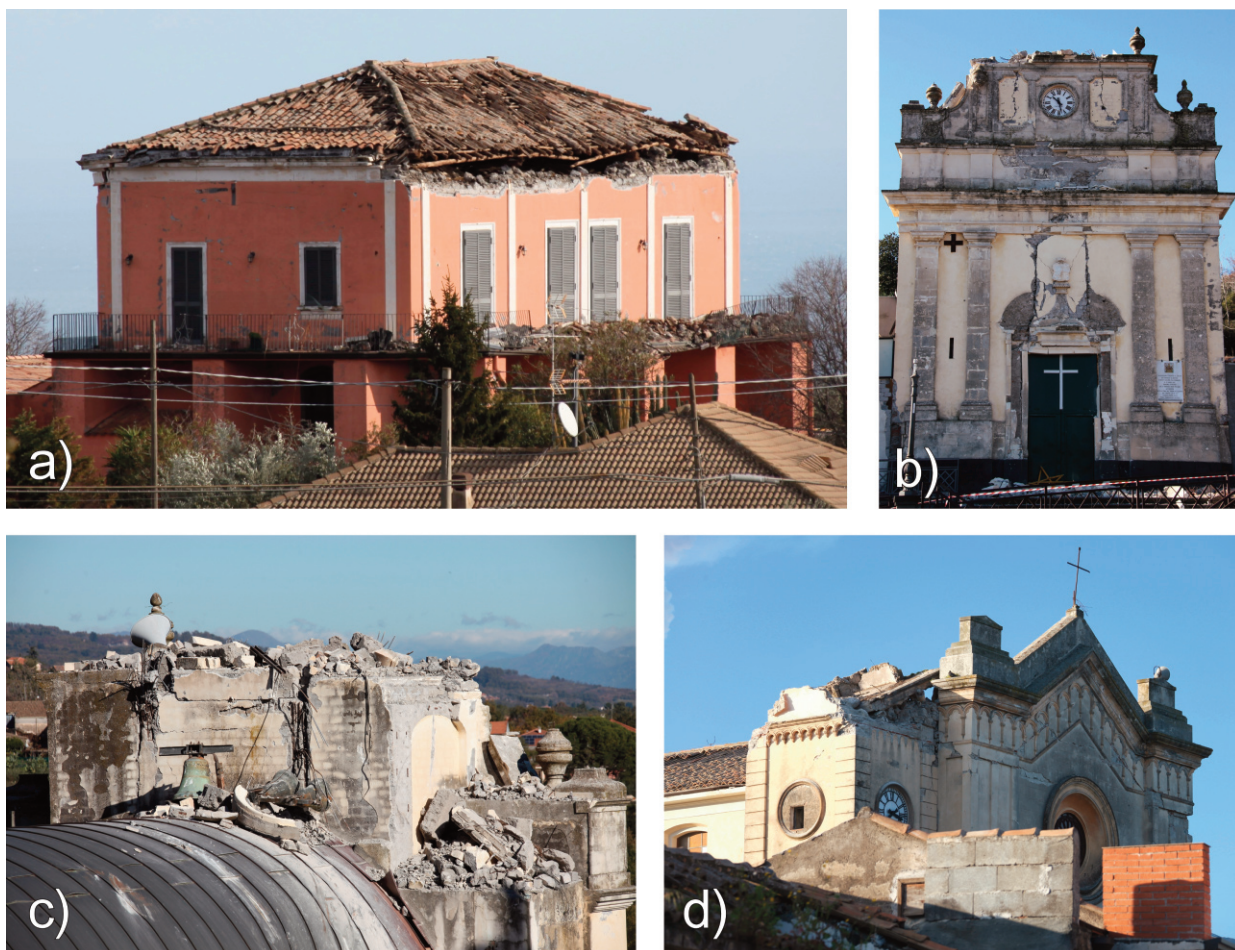
Foto 8 a) Fiandaca: danno molto grave (grado 4) ad un edificio in muratura (cl. B); b) Fleri: particolare del danneggiamento alla facciata della vecchia Chiesa Madre, restaurata dopo il sisma del 1984; c) idem; d) Pennisi: particolare del crollo del campanile della chiesa della Madonna del Carmelo.
