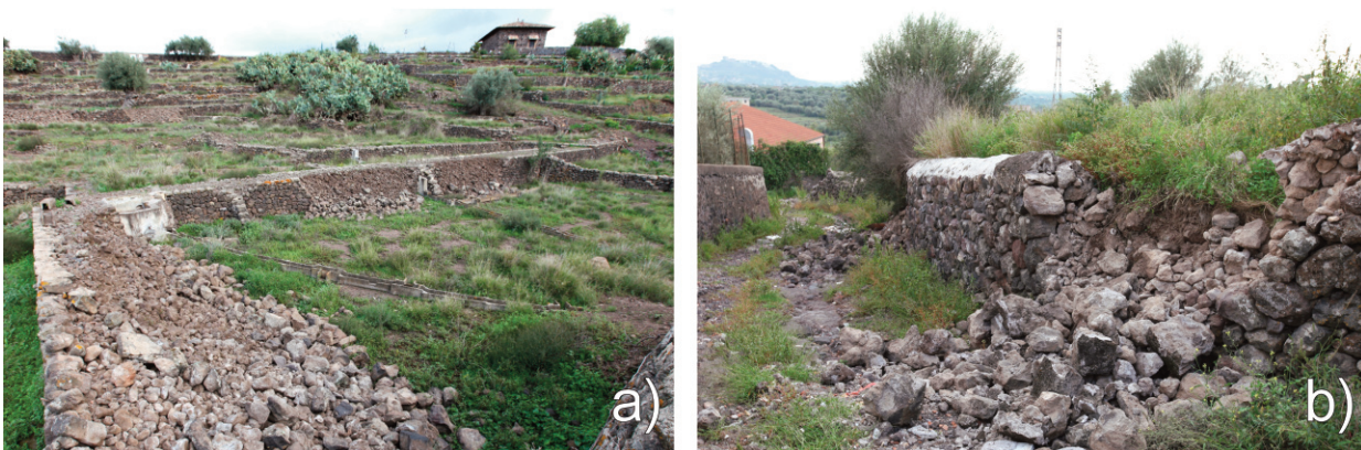
Foto 4 C.da Mendolito (S. Maria di Licodia): a) la maggior parte dei muri di contenimento dei terrazzamenti appaiono franati; b) diffusi i crolli dei muretti a secco delimitanti strade e proprietà.
