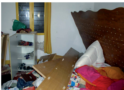
Interno di una camera da letto dopo il terremoto di Finale Emilia del 20 maggio 2012, Magnitudo=6.1 . Le pesanti mensole sono cadute sul letto insieme agli oggetti che vi erano appoggiati. I danni hanno anche reso difficile l'evacuazione.
