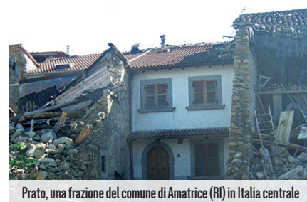
Prato, una frazione del comune di Amatrice (RI) in Italia centrale
