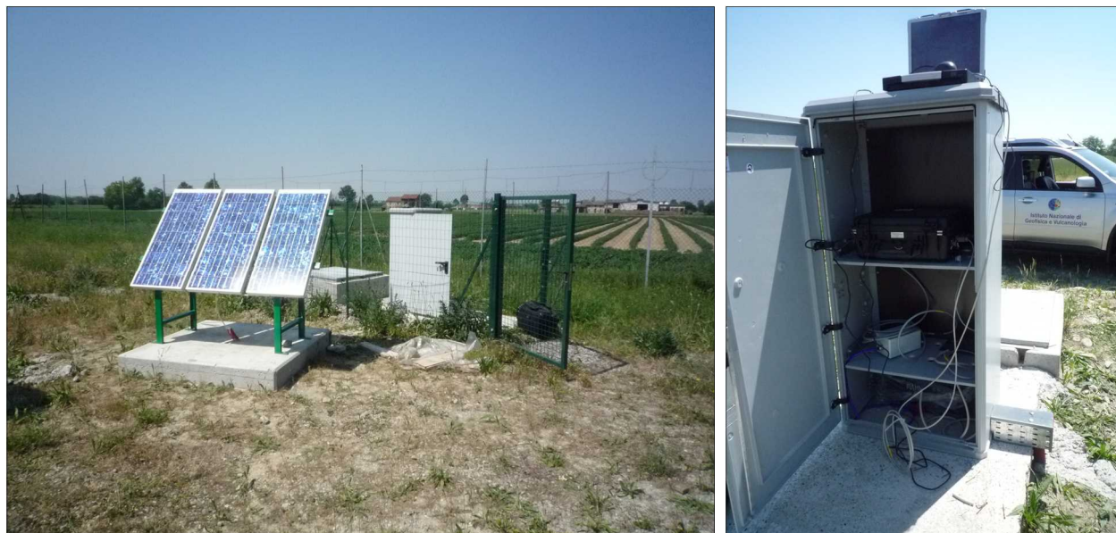
Fig.31. Esempio di stazione sismica installata in provincia di Piacenza con un sistema di alimentazione con pannelli solari. Al centro è visibile il pozzetto in cemento prefabbricato con coperchio che contiene il sensore sismico, isolato dagli agenti atmosferici e dagli sbalzi di temperatura e pressione; a sinistra l'armadio a norma IP66 contenente tutti i componenti della stazione sismica, collegato con un corrugato interrato sia al pozzetto sia al supporto dei pannelli solari. Nella foto di destra si può osservare il dettaglio della stazione sismica alloggiata in un armadio standard a norma.
