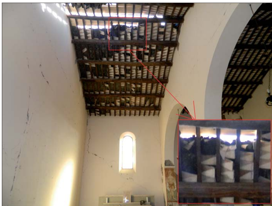
Figura 23 – Chiesa Madonna della Torre: danni in copertura
