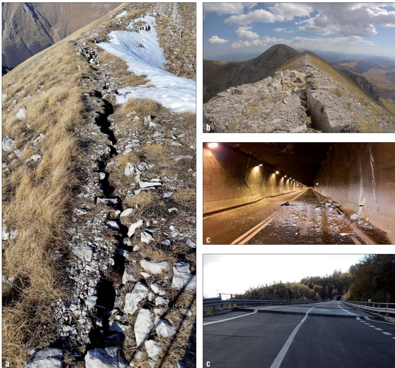
Figura 11 – a) Fratture in cresta a Cima Vallelunga; b) Monte Argentella; c) galleria Capodacqua: la frattura corrisponde alla dislocazione prodotta dalla faglia del Monte Vettore; d) viadotto Capodacqua
