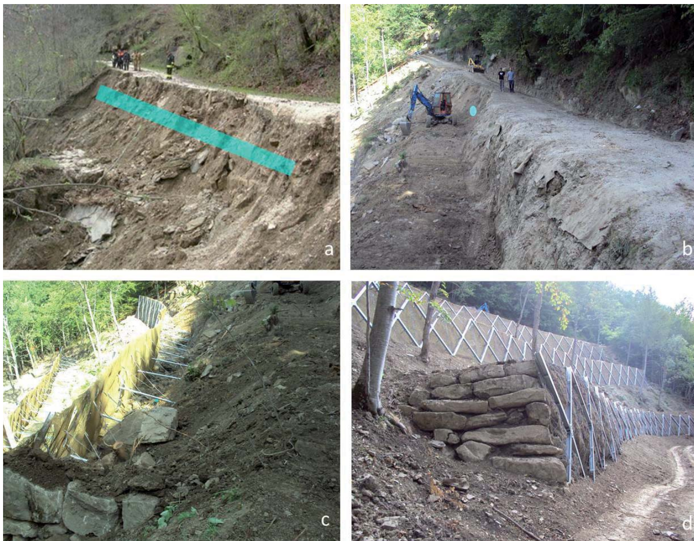
Figura 7 – Cedimento, a causa del sisma, della strada di servizio al di sotto della quale corre la condotta dell'Acquedotto del Chiarino, non visibile nella foto ed evidenziata in celeste (a); interventi di ricostruzione della sede stradale (b) e realizzazione delle opere di sostegno (c) e (d)
