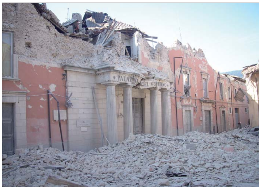
Figura 1 – Il palazzo della Prefettura dell'Aquila dopo il sisma del 6 aprile 2009
