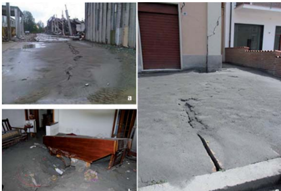
Figura 2 – esempio di danni correlati anche a fenomeni di liquefazione a seguito della scossa Mw=6,09 del 20 maggio 2012: a) crollo di capannone a Mirabello; b) e c) danni ad edifici residenziali a S. Carlo
