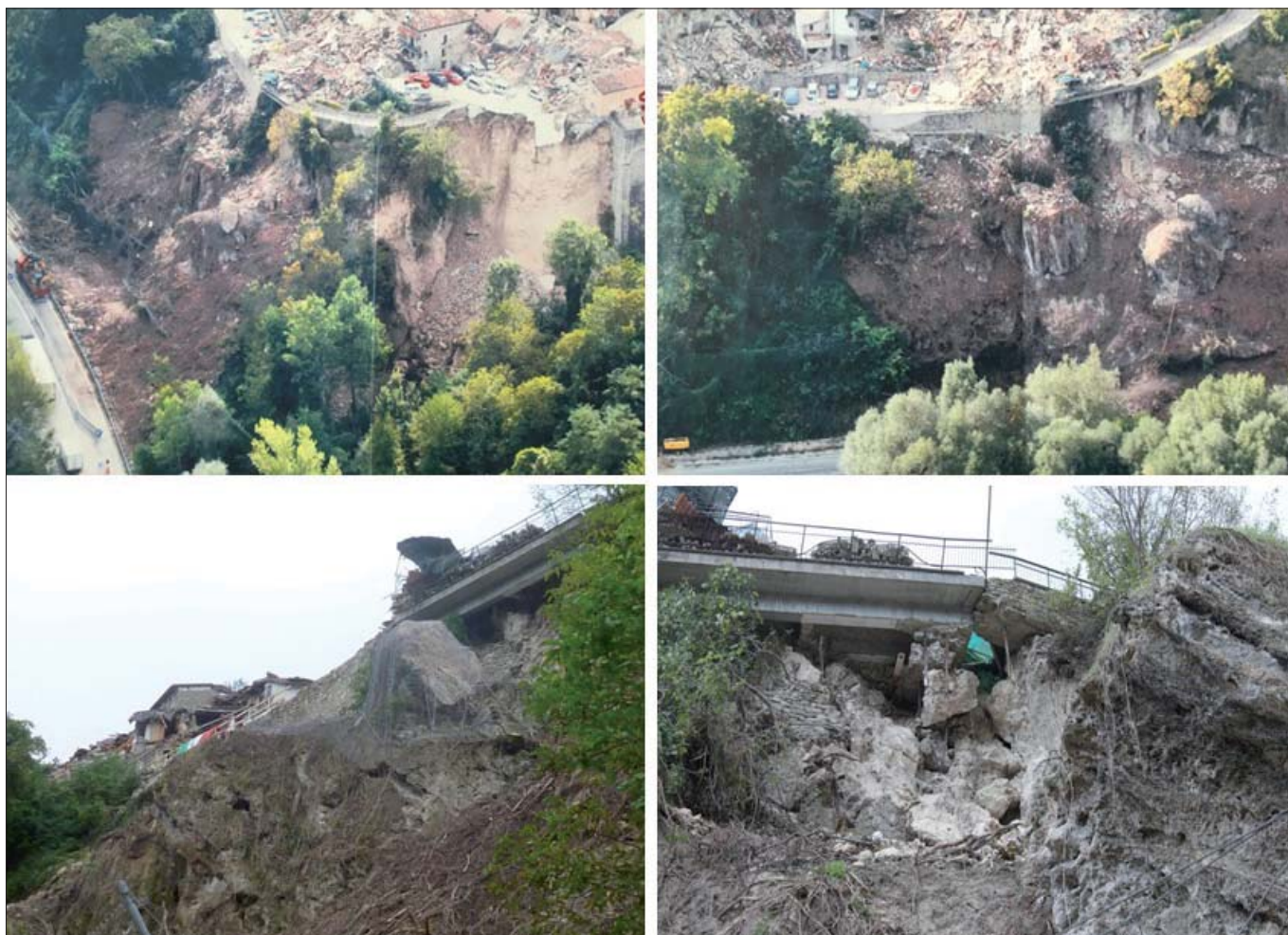
Figura 19 – Il rischio di crolli a seguito del sisma del 24 agosto 2016 sulla SS4 Salaria sotto l'abitato di Pescara del Tronto
