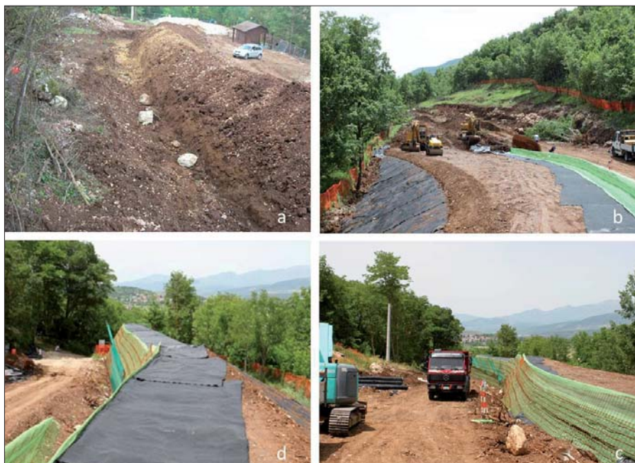
Figura 10 – Fasi di realizzazione del tomovallo: a - scavi di fondazione con prove di caduta massi; b - realizzazione del 1° livello dell'opera; c - completamento della sommità; d - impermeabilizzazione del tomovallo
