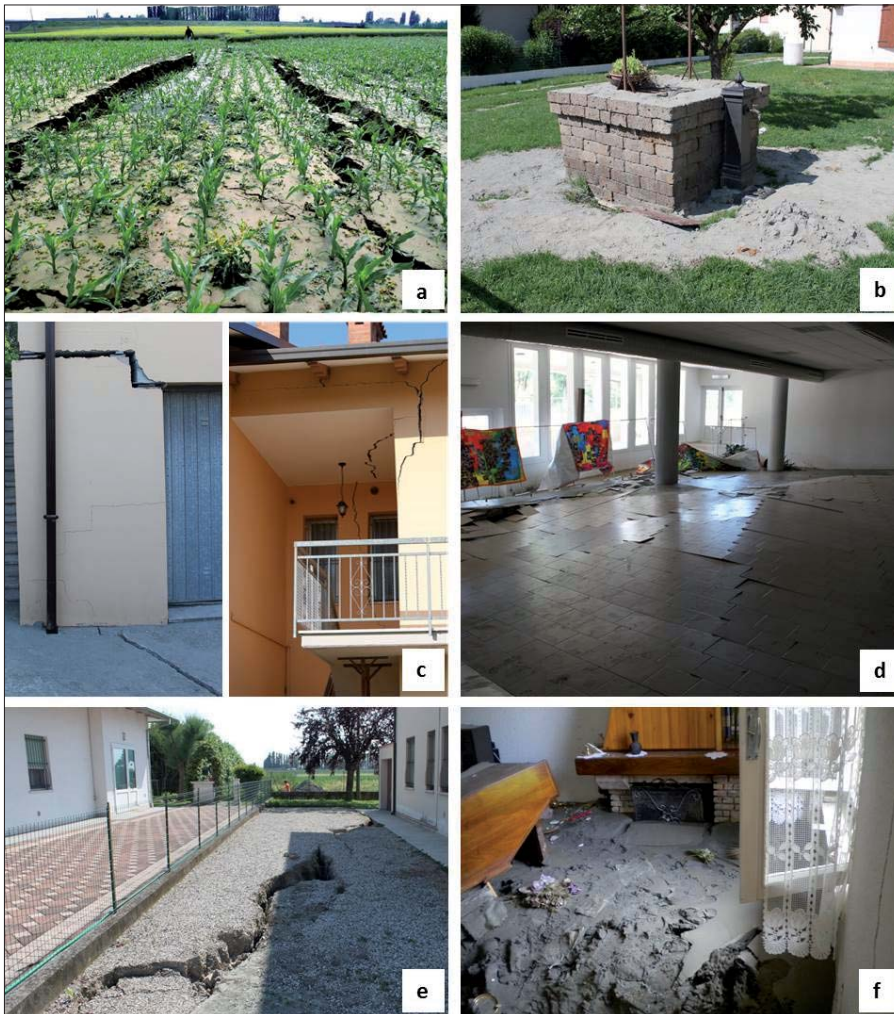
Figura 13 – Effetti dei fenomeni di liquefazione: a – fratture con andamento ad enclenon in un campo coltivato; b – fuoriuscita di sabbia da un pozzo; c – fratturazione del terreno con lesioni strutturali ad un edificio; d – rialzamento del pavimento di un vano al piano terra; e – frattura in prossimità di un edificio senza danni per il medesimo; f – invasione di sabbia al piano terra di un appartamento
