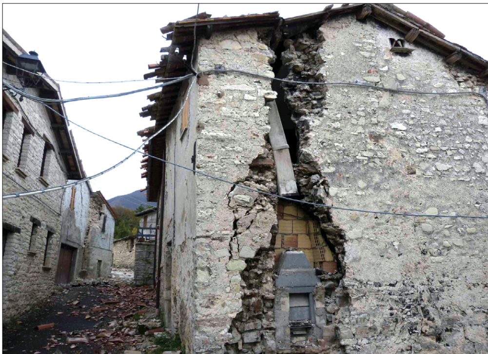
Figura 3 Edificio con catena tagliata per far posto a una canna fumaria (Gualdo, frazione di Castel Sant’ Angelo sul Nera, novembre 2016).
