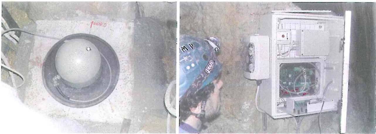
Fig. 11: la parte ipogea della stazione sismica di Cesi (TR): a) a sinistra, il sismometro prima della schermatura provvisoria; b) a destra, l'apparato elettronico di alimentazione e di registrazione e trasmissione del segnale sismico (foto P. Casale).
