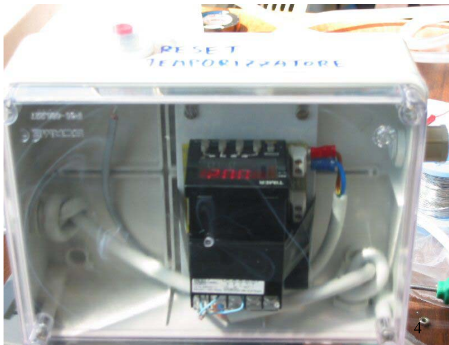
Fig. 4. Il temporizzatore digitale utilizzato per il controllo degli intervalli di funzionamento della pompa.
