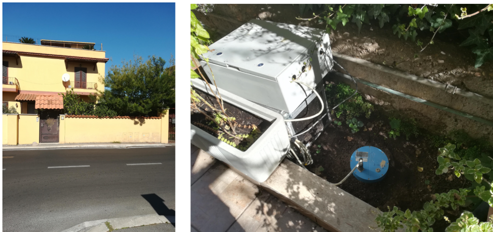
Figura 3. Stazione sismica installata all'interno dell'abitazione privata di Via Fagnano 9. A destra un dettaglio del sensore Le3D-5s, con acquisitore digitale, batteria e router collocati all'interno della scatola grigia.
